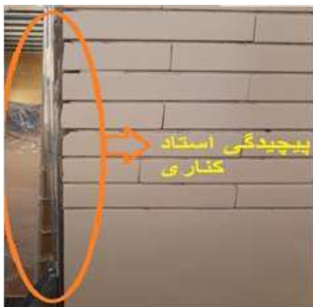
شکل (۱۵) خرابی در دیوار A1 پیچیدگی استاد کناری
