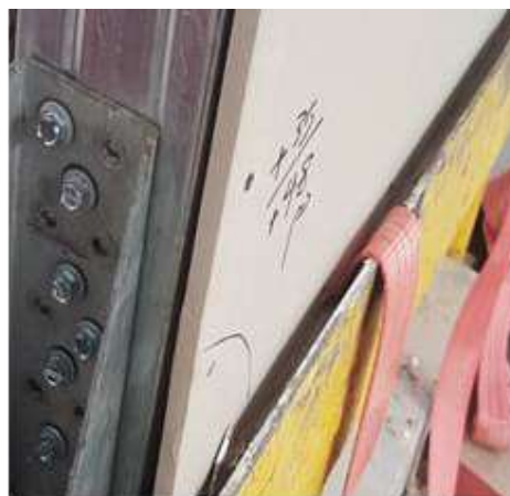
شکل (۱۷) مود خرابی در دیوار A2
