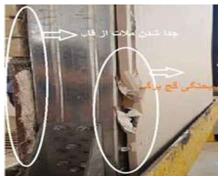
شکل (۱۳) خرابی در دیوار A1
