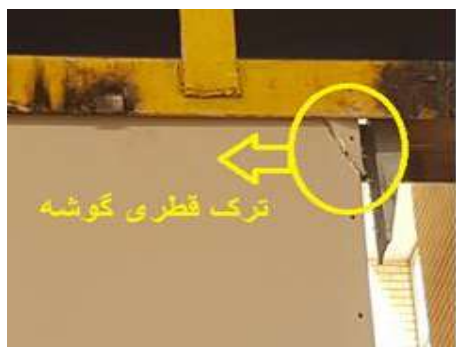
شکل (۱۶) مود خرابی در دیوار A2
