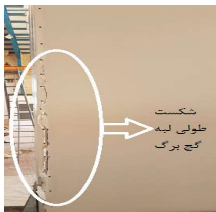
شکل (۱۴) خرابی در دیوار A1
