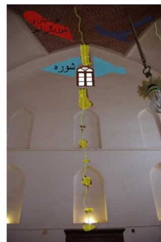
شکل (۴): ترک عمده دیوار باربر گنبد [۱].
