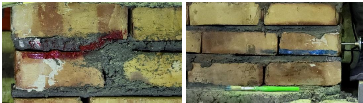
شکل ۷: ترک های ایجاد شده جابه جایی ۳.۶mm - آبی: سمت راست دیوار / قرمز سمت چپ دیوار
